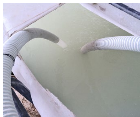
Fig. 1 PersulfOx nella vasca di miscelazione. L'attrezzatura utilizzata è realizzata con materiali chimicamente resistenti.
